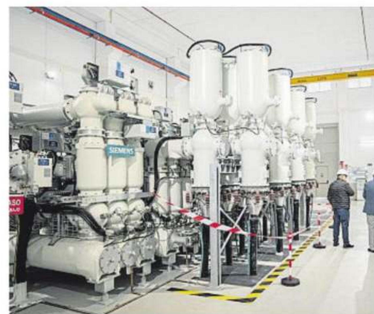
Interior de la subestación Cerda
